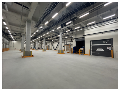
冷蔵倉庫内部
